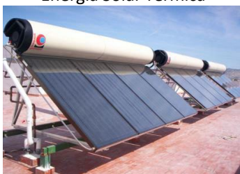
Energía Solar Térmica
