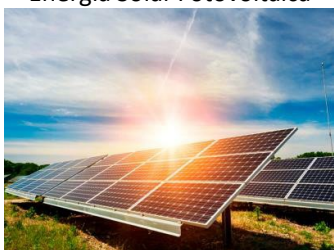
Energía Solar Fotovoltaica
